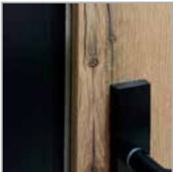
listwa (widoczna po zamknięciu drzwi)
